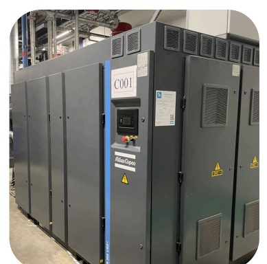
Nouveau compresseur - ANL Wellen
