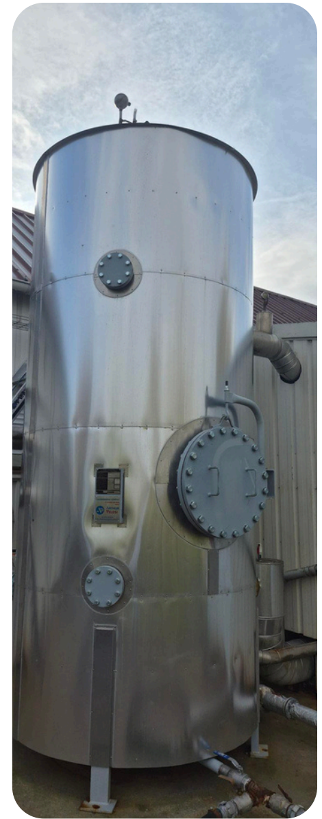
Cuve eau installée en 2025 Somater Mortagne
