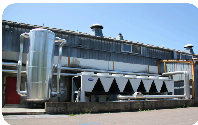
Système de récupération de chaleur
