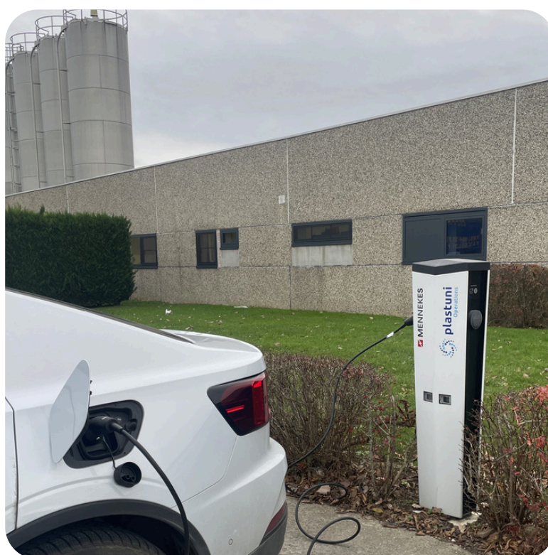
Bornes de recharges électrique - Plastuni Opérations
