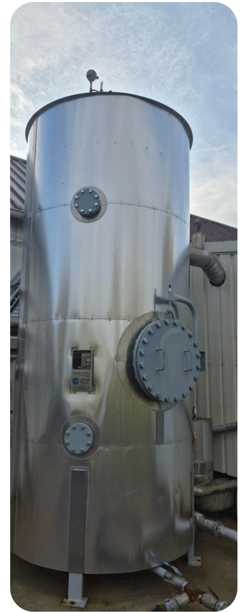
Cuve eau installée en 2025 Somater Mortagne
