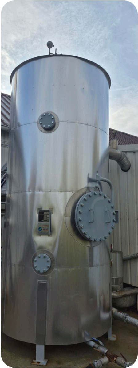
Cuve eau installée en 2025 Somater Mortagne
