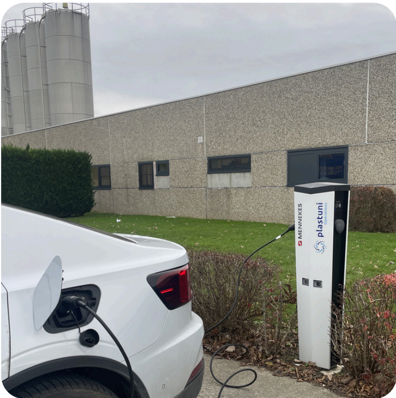
Bornes de recharges électrique - Plastuni Opérations
