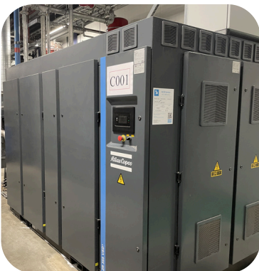
Nouveau compresseur - ANL Wellen
