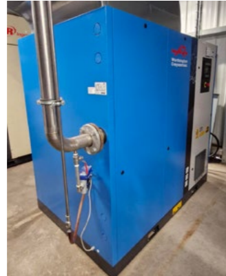
Nouveau compresseur sur le site de Mortagne
